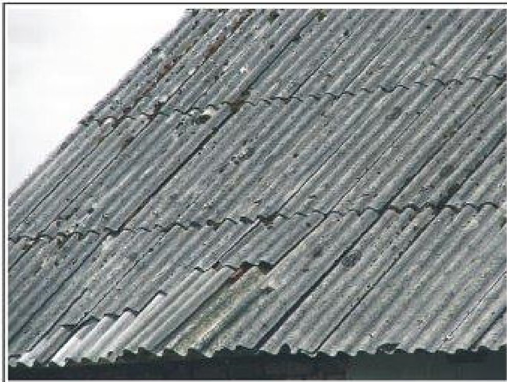
Fot.1 Pokrycie dachowe budynku gospodarczego z płyt falistych - I stopień pilności
